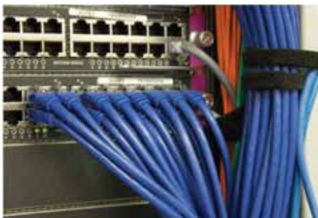
شکل ۲۵-۴- اتصال کابل‌ها به پیچ پانل
